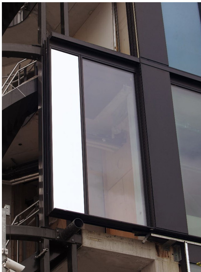
Abbildung 2: Die Fassadenelemente mit Festverglasungen aus Funktions-Isolierglas sind mit einer auf dem Standardfassadensystem HUECK Trigon Unit L basierenden Sonderlösung realisiert. Die elektronisch gesteuerten Paneele wurden nachträglich montiert. (Quelle: HUECK)
